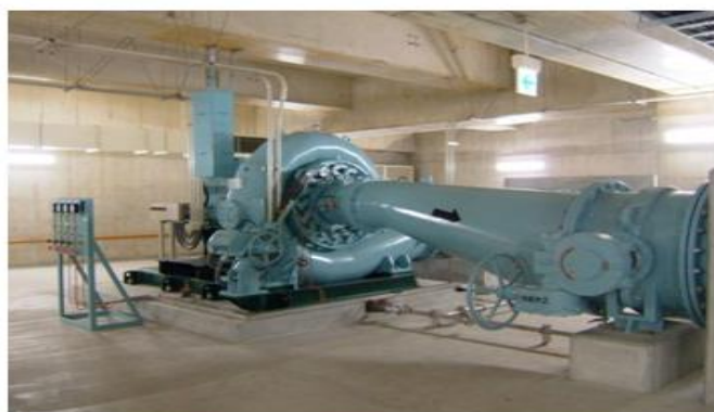
長居配水場に設置した水力発電設備
