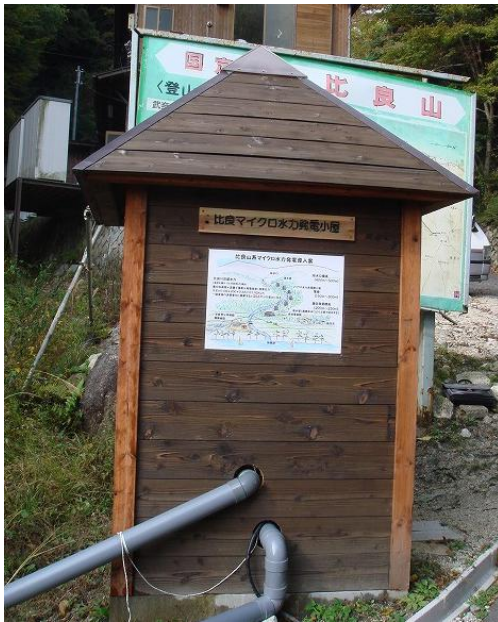
写真2. 比良のマイクロ水力発電小屋 13)
